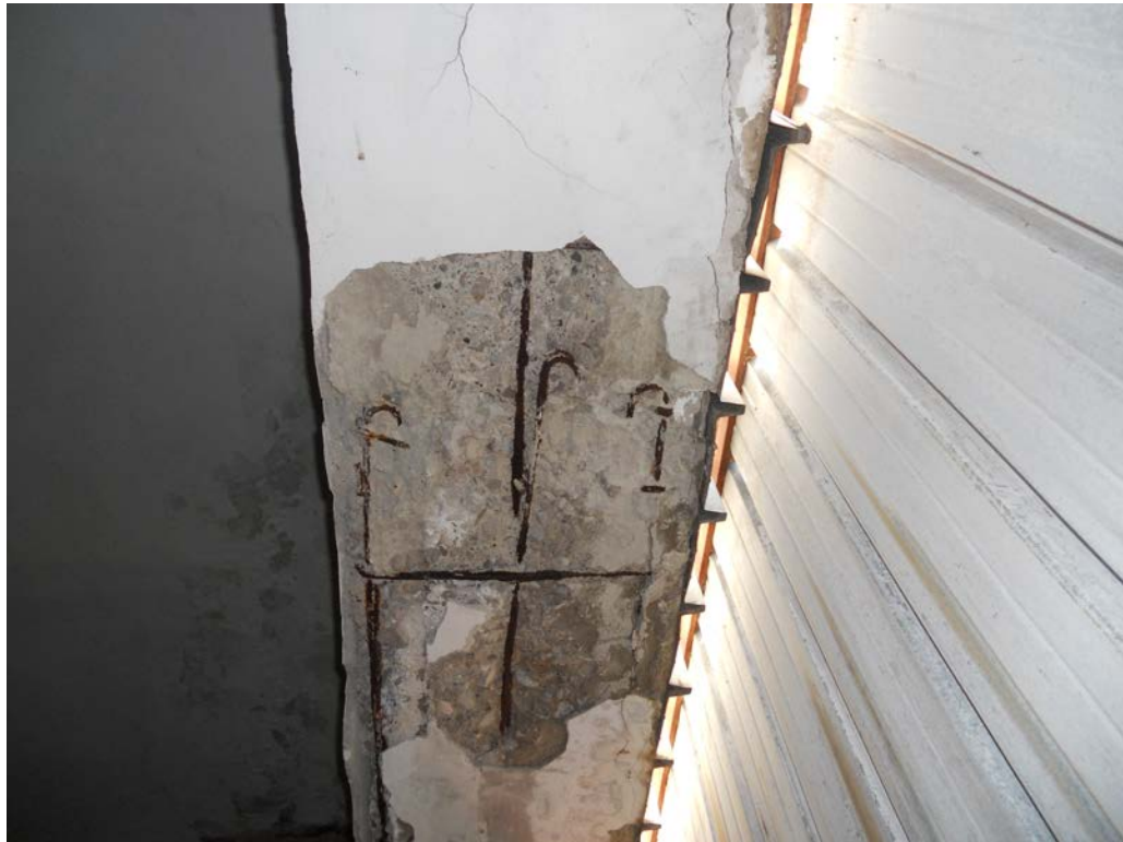
Pilastro porta ingresso Pad. 7 - Effetto dell'esplosione del copriferro.
