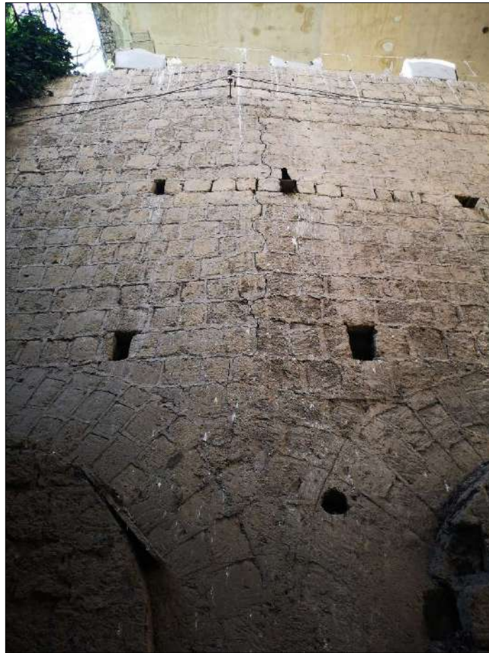
Foto 1: Lesione che interessa tutta l'altezza del muro.
