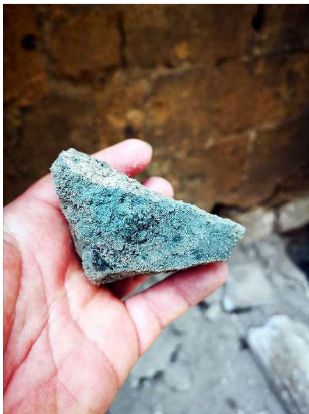
Foto 10: Dettaglio del cemento fuso presente alla base della fondazione.
