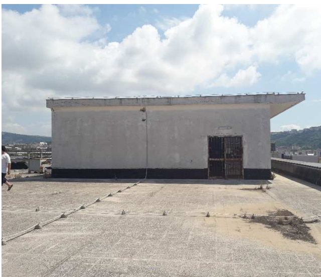
Immagine della copertura esterna disperdente
