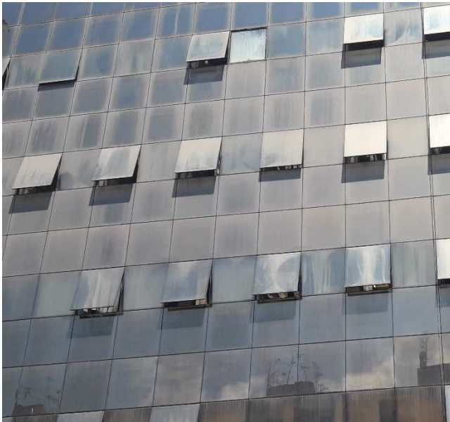
Immagine relativa al degrado della parte più esterna del vetro di facciata
