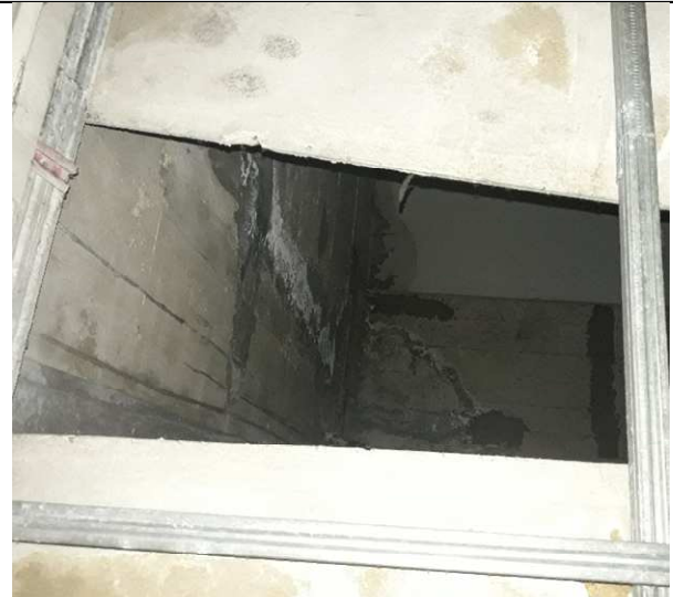
Immagine relativa al degrado dovuto ad infiltrazioni
