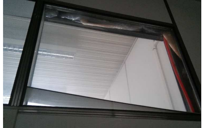
Immagine relativa al degrado delle partizioni interne.
