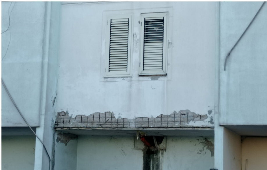
Figura 5.17 – Corrosione delle armature delle pareti di tamponamento al piano primo
