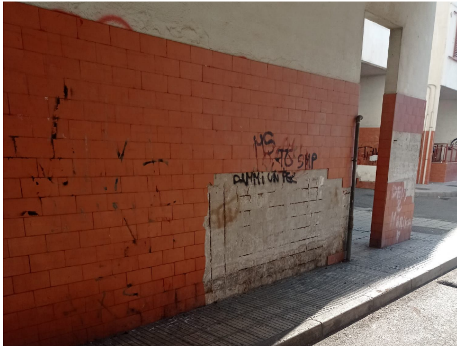
Figura 5.16 - Corrosione delle armature delle pareti al piano terra con scalzamento del copriferro e della finitura di rivestimento
