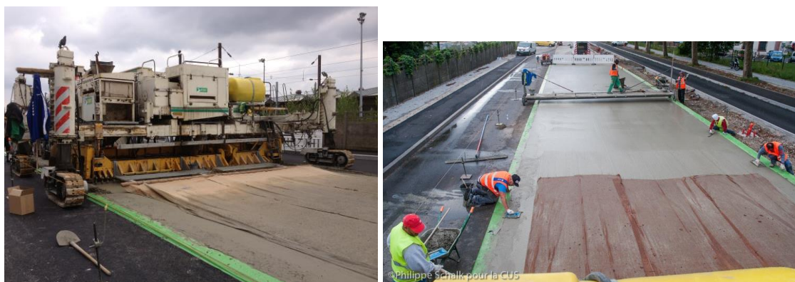
fig.49 - Predisposizione del manto stradale. BHNS Ligne G - Strasbourg, De la Gare centrale de Strasbourg à l'Espace Européen de l'Entreprise à Schiltigheim, février 2017
