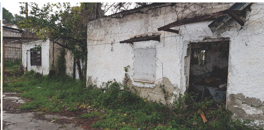
FOTO 10 (part.723 - sub 3) - SOLAIO CROLLATO
