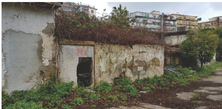
FOTO 9 (part.723 - sub 4) - SOLAIO CROLLATO
