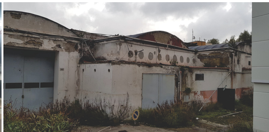
FOTO 4 (part. 69) - MURATURE E TRAVI DISSESTATE
