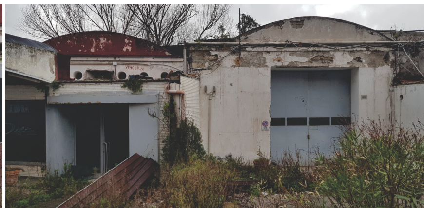
FOTO 2 (part. 69) - MURATURE E TRAVI DISSESTATE
