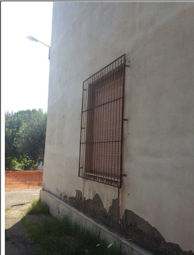
Immagine relativa al degrado del pacchetto di muratura con distacco dell'intonaco
