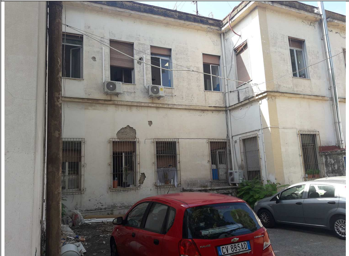
Immagine relativa al degrado del pacchetto di muratura con distacco dell'intonaco
