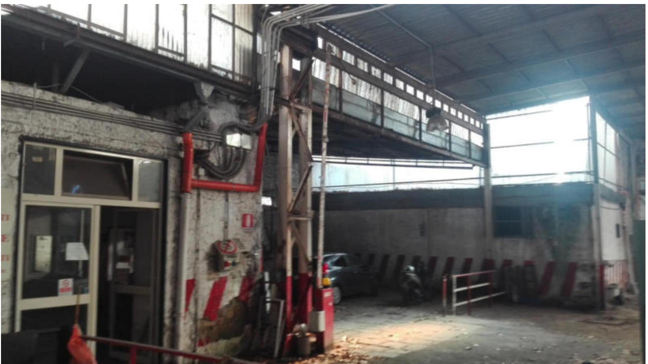
Foto n. 16. Vista della zona di ingresso al capannone di via Nicolini n. 47. Si distingue in primo piano a sinistra il vecchio corpo di fabbrica in muratura di tufo ad unico livello posto sul fronte strada di via Nicolini ed a destra l'area di ingresso al capannone prima scoperta e poi coperta con lamiera.
