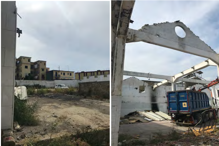
Foto relative alle operazioni di messa in sicurezza e di smontaggio delle coperture esistenti.
