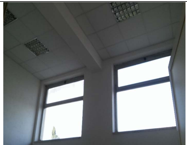
Dettaglio delle lampade installate
