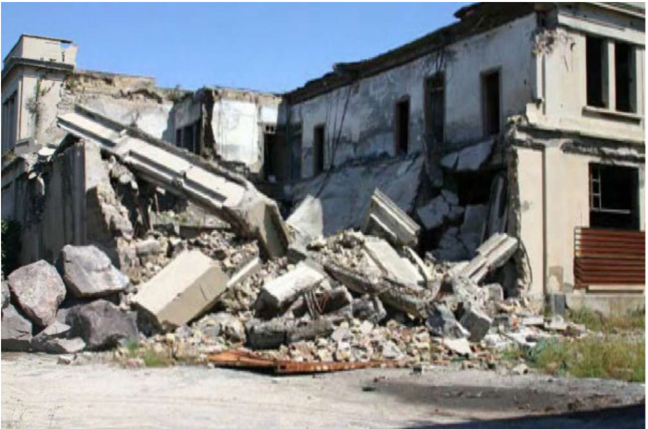
Figura 59 - Edificio 11, Uffici e magazzini spedizioni. Crolli visibili dall'esterno.
