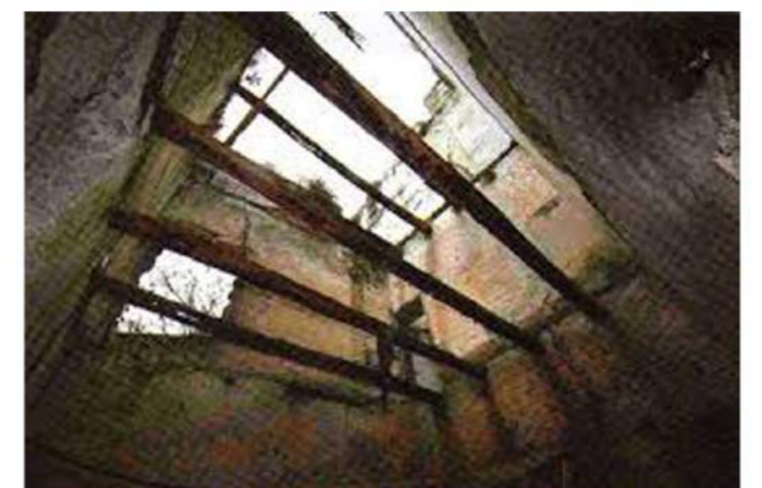
IMMAGINI DELL'ATTUALE STATO DI DEGRADO DEL COMPLESSO
