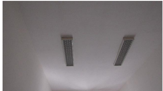
Figura 4.4 - Particolare dei corpi illuminanti ubicati nelle sale espositive
