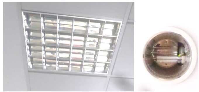
Figura 8.1 – Particolare delle lampade in sostituzione
