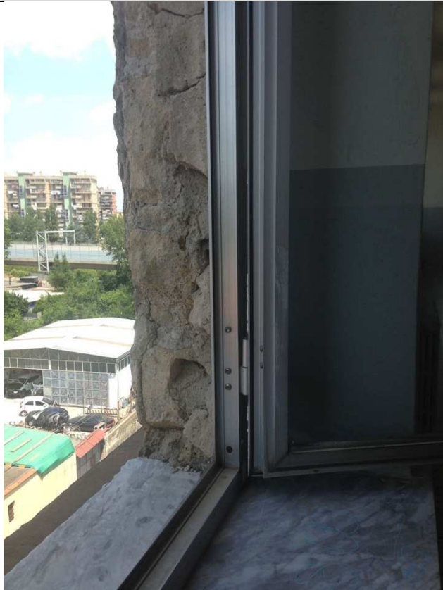
dettaglio parete esterna in tufo e serramento in alluminio e vetro singolo
