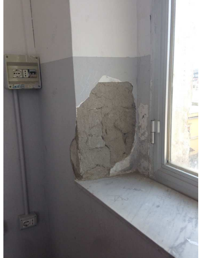
Immagine relativa al degrado dell'intonaco esterno in corrispondenza delle finestre del quarto piano fuori terra
