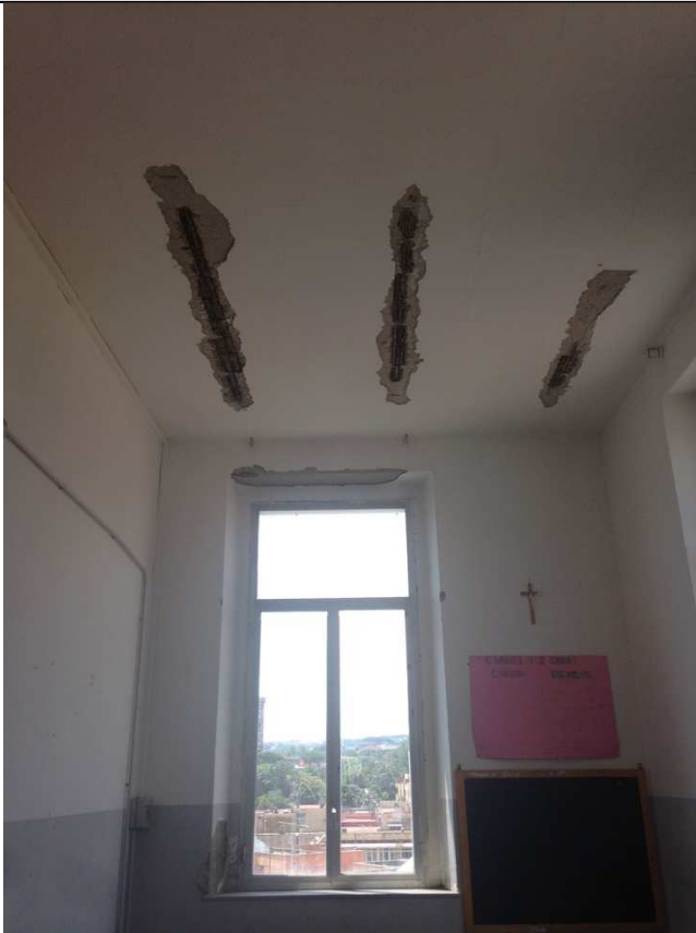
Immagine relativa al degrado dell'intonaco sull'intradosso del solaio di copertura
