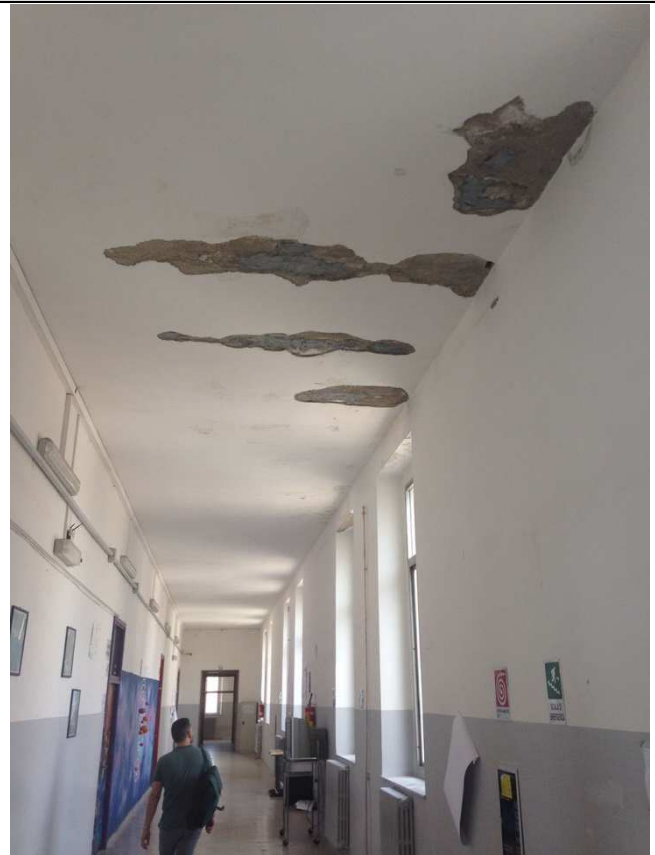
immagine relativa al degrado dell'intonaco sull'intradosso del solaio di copertura
