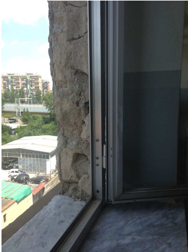
Immagine relativa al degrado dell'intonaco esterno in corrispondenza delle finestre del quarto piano fuori terra
