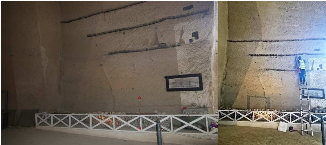
Figura 22. Parete della “Navata dei Pezzentelli” interessata da un diffuso quadro fessurativo (a sinistra) e operazioni di installazione di fessurimetri planari (a destra).
