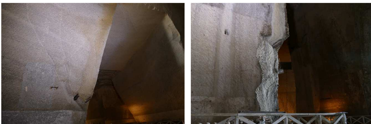
Figura 15. Putrelle metalliche ossidate infisse nell'ammasso tufaceo
