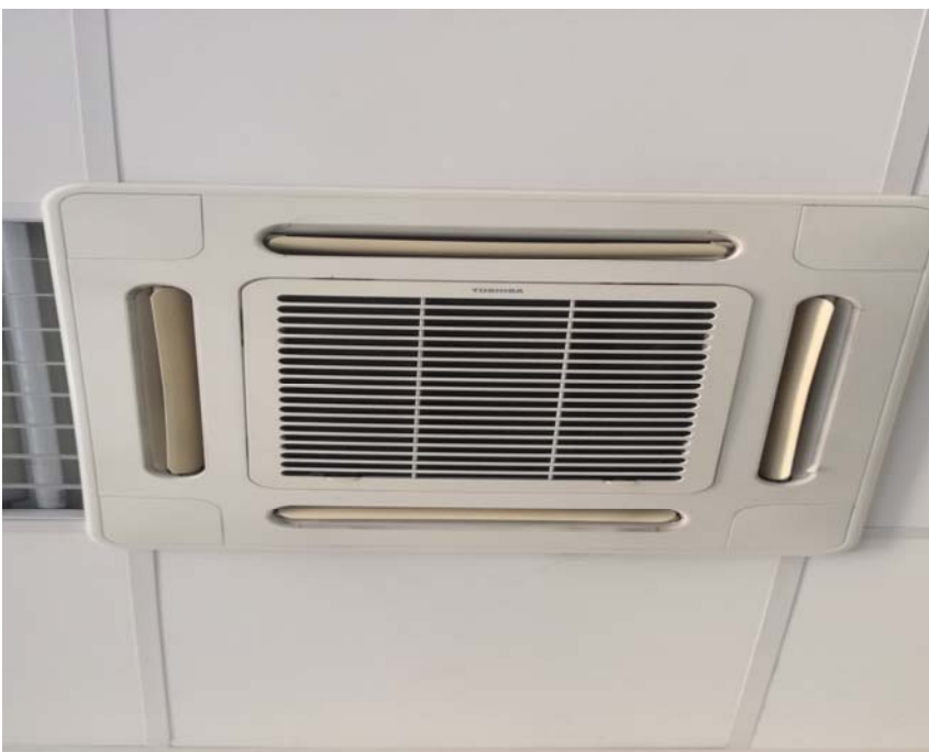
Unità interne a soffitto
