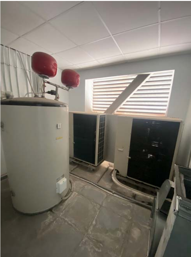
Boiler elettrico per la produzione di ACS
