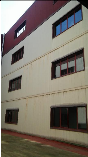
Immagine relativa al degrado del pacchetto di muratura
