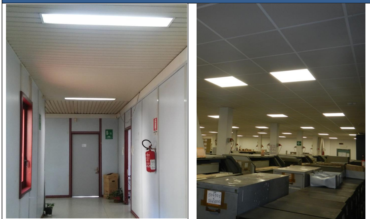
Dettaglio delle lampade a neon presenti nei locali dell'edificio
