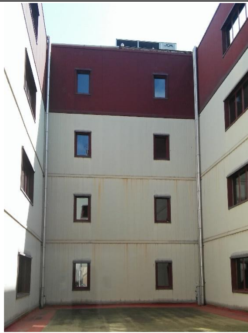
Dettaglio dell'alterazione sul lato corto del cavedio
