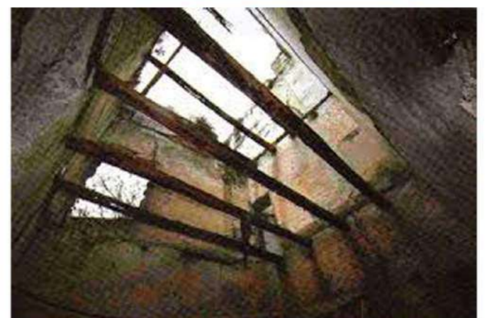
IMMAGINI DELL'ATTUALE STATO DI DEGRADO DEL COMPLESSO
