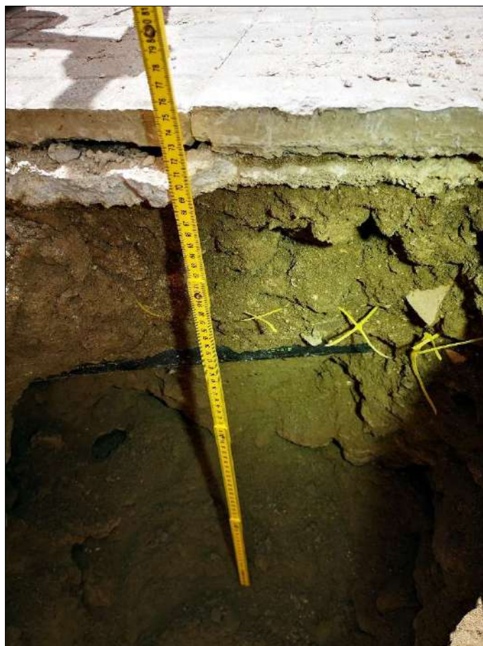
Foto 3: Particolare dello scavo; visibile tubo nero per cavo sul lato opposto rispetto alla scala del Petraio.
