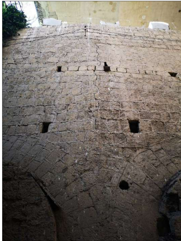
Foto 1: Lesione che interessa tutta l'altezza del muro.
