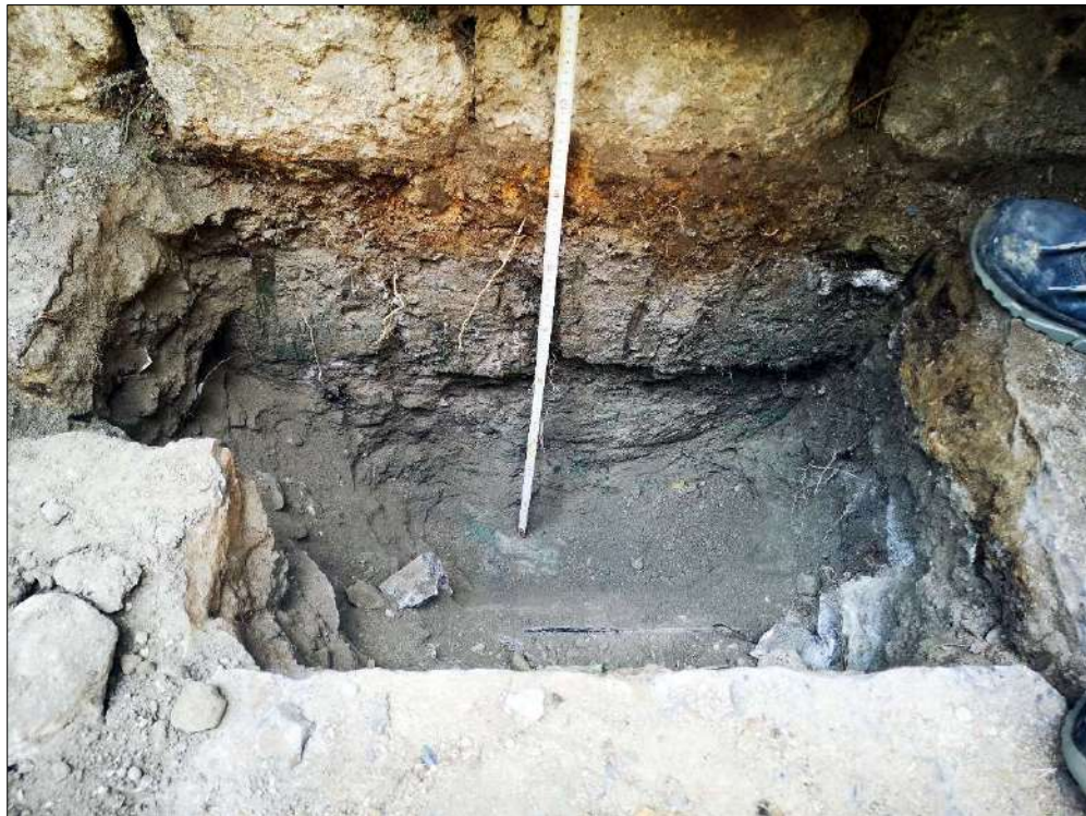
Foto 9: Scavo n° 2 ultimato in coincidenza di un livello di cemento fuso su cui è posizionata la fondazione
