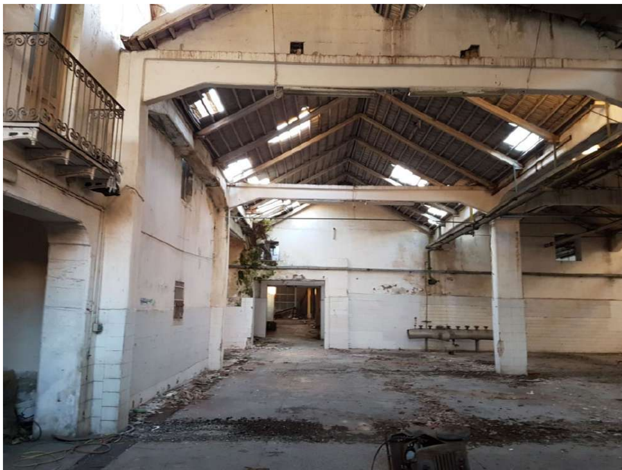
Interno di uno degli edifici esistenti, realizzato in muratura portante mista a pilastri e travi in cemento armato. La copertura è composta da arcarecci in legno e manto di tegole.
