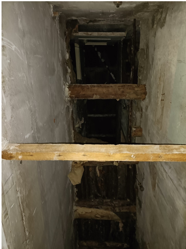
Foto 9 – solaio parzialmente crollato
