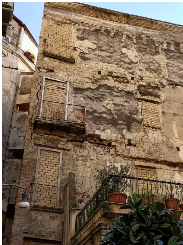
Foto 1 – situazione riscontrata in data 27/01/2023
