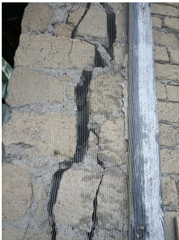
Foto 4 – particolare dissesto cantonale
