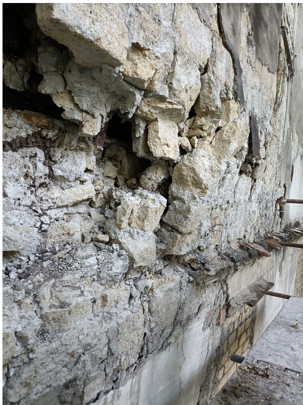
Foto 5 – particolare dissesto facciata
