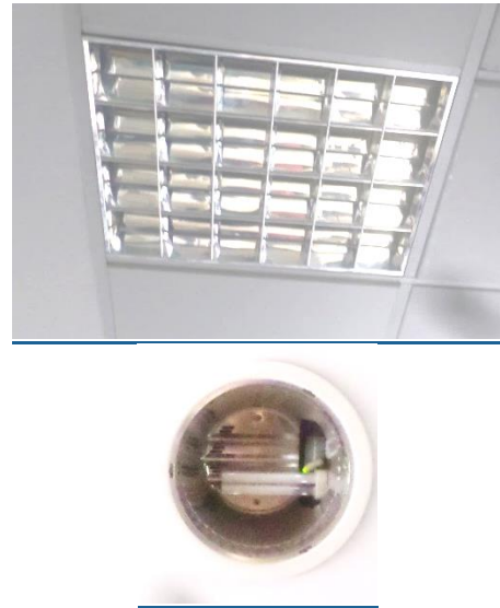
Figura 4.9 - Particolare dei corpi illuminanti
