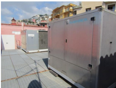
Figura 17 - Particolare di pompe di calore poste sul tetto
