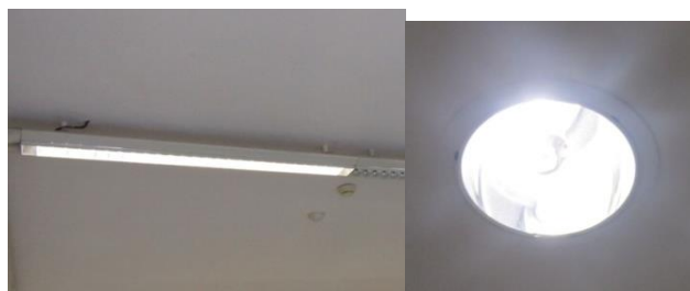
Figura 33 – Particolare delle lampade in sostituzione
