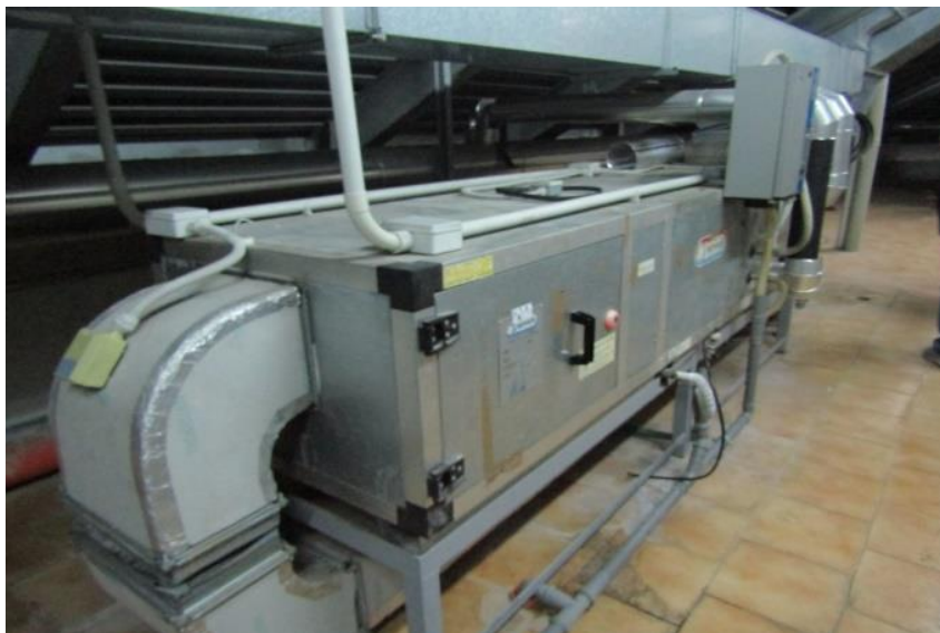
Figura 20 - Particolare unità trattamento aria UTA (sottotetto)
