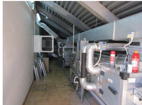
Figura 23 - Particolare di una delle UTA
