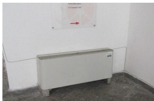
Figura 21 - Particolare di un fancoil
