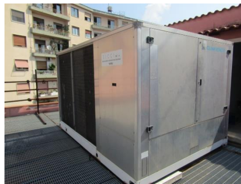
Figura 18 - Particolare di pompa di calore
