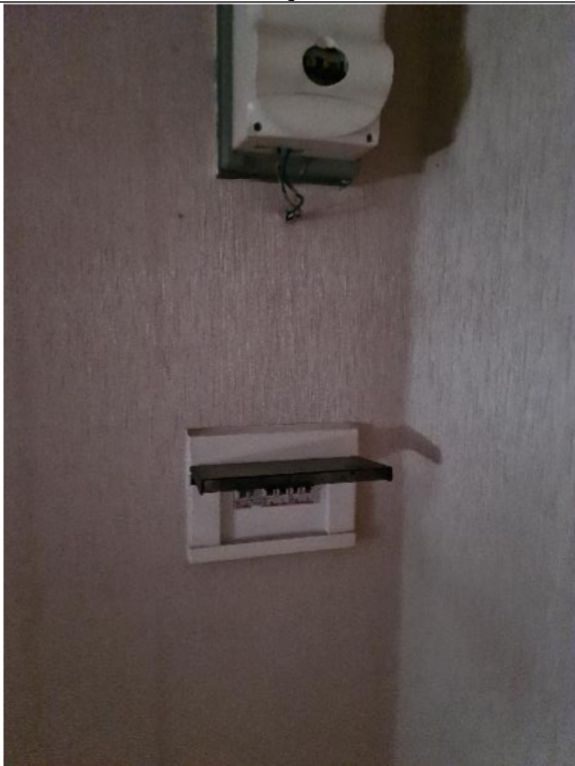
n.7 – Vista quadro elettrico
