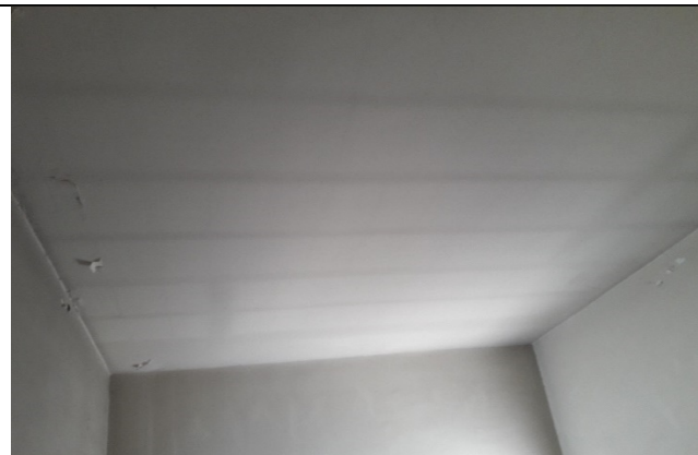
Immagine interna che rivela la presenza di solai in latero-cemento anche in corrispondenza della copertura
