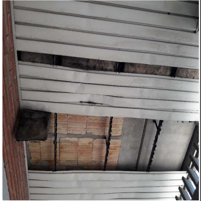
Dettaglio dell'usura della coibentazione del solaio disperdente sul porticato di accesso all'edificio
