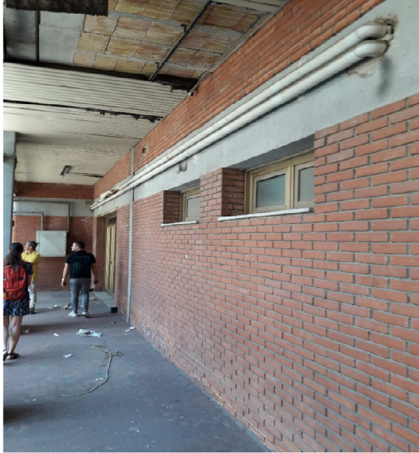
Degrado delle finiture delle strutture orizzontali inferiori del fabbricato
