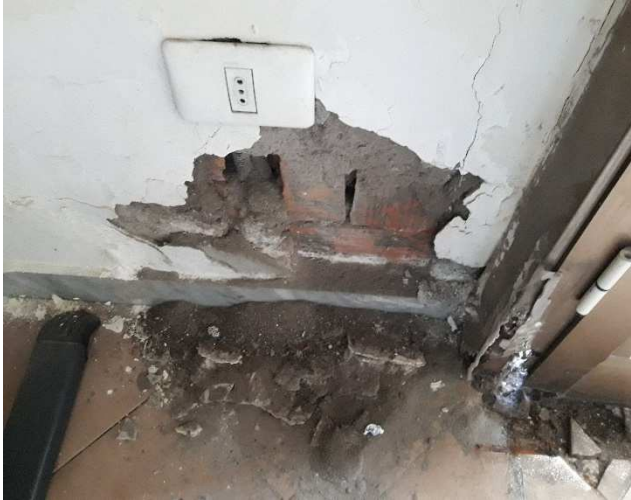
Degrado delle murature interne nei vari livelli
