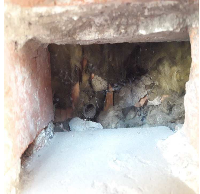
Dettaglio del degrado della muratura in paramano sul fronte nord-ovest del fabbricato
