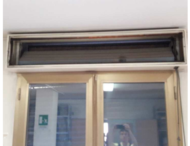
Dettaglio del degrado di alcuni cassonetti presente in tutti i piani
