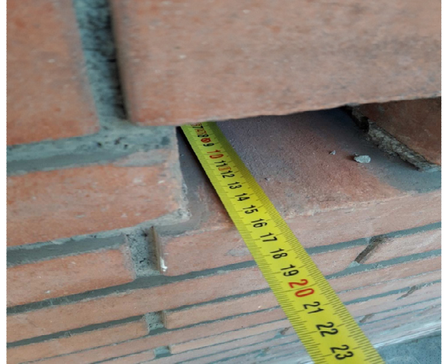
Misurazione dello spessore della muratura esterna comprensiva dell'aria e dello spessore dell'isolante
