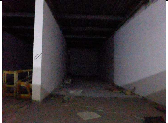
Assenza parziale di illuminazione dei locali e dei percorsi
