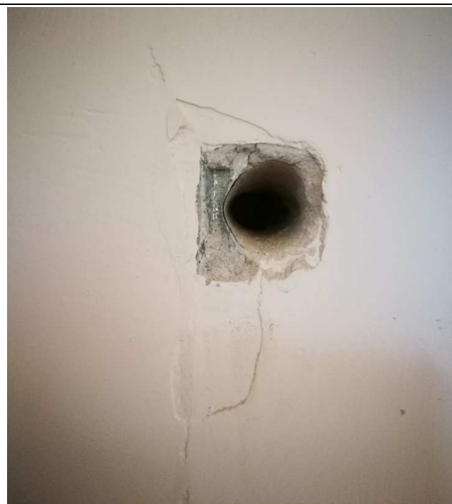
Dettaglio del foro che rivela la presenza del muro pieno in c.a.
