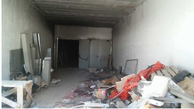
Degrado dei locali e dei percorsi di parte dell'interrato
