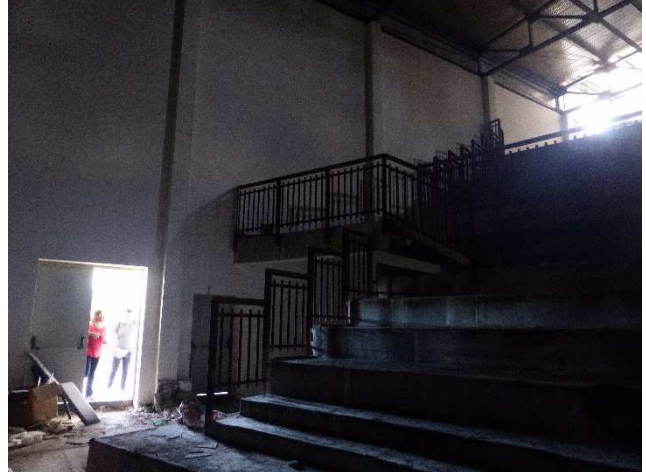
Immagine che rivela lo stato di abbandono
