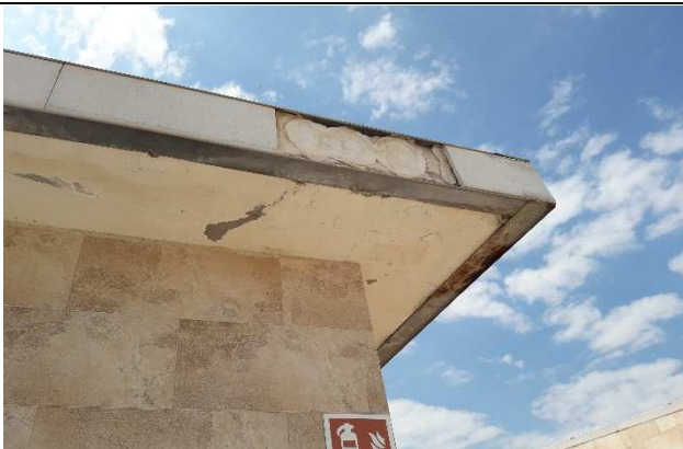
Distacco dei rivestimenti dei cornicioni
