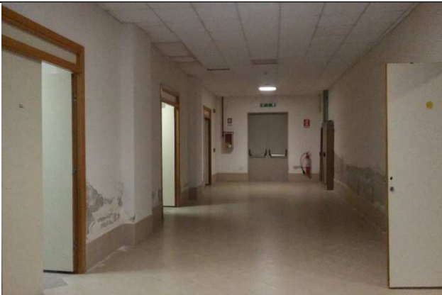
Degrado diffuso negli spazi di distribuzione
