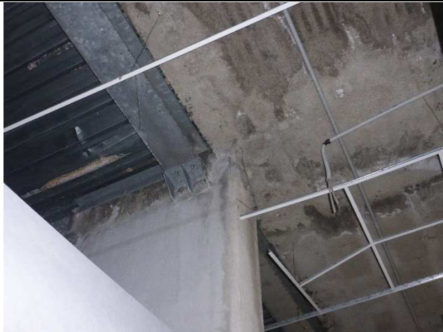
Degrado generale diffuso delle strutture dell'interrato
