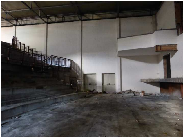
Il locale non è mai stato terminato dalla costruzione dell'edificio
