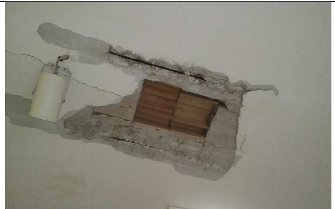
Distacco degli intonaci dai solai interni in latero-cemento
