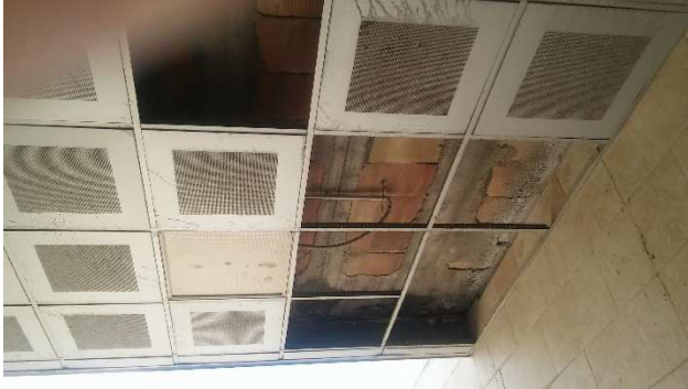
Degrado degli orizzontamenti interni
