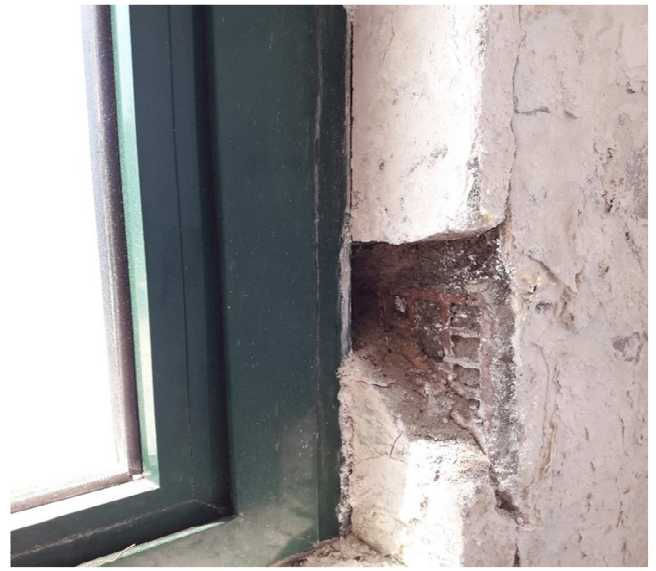
Immagine che rivela il dettaglio del degrado interno del fabbricato
