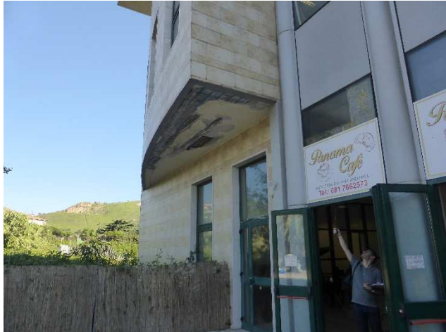
Degrado degli orizzontamenti esterni inferiori
