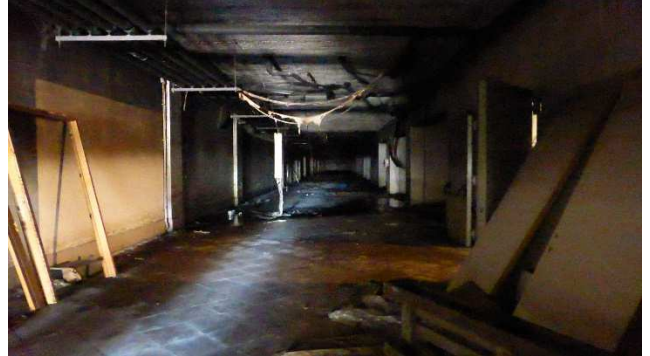
Immagine dei locali a seguito del recente incendio
