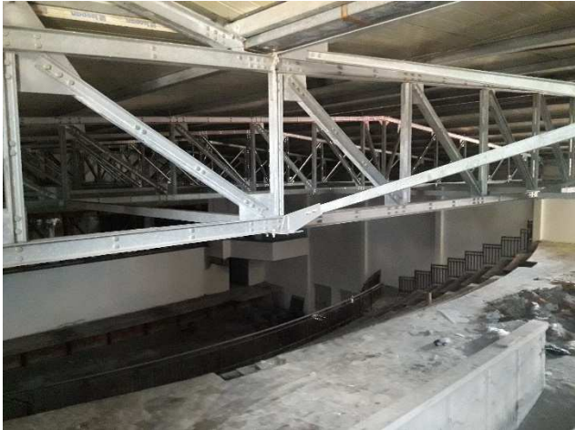
Degrado dei locali dell'auditorium
