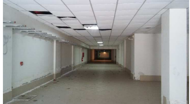
Immagine che rivela il degrado delle controsoffittature
