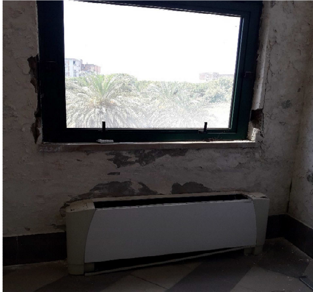
Degrado dei muri verticali interni
