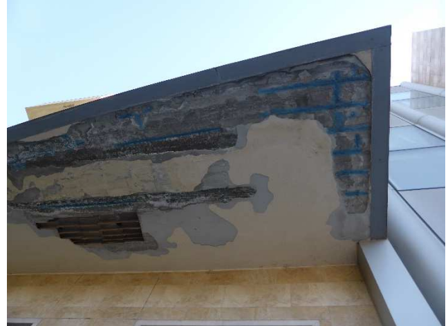
Immagine che rivela il degrado delle armature
