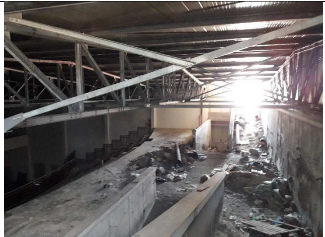
Immagine che rivela il degrado dell'auditorium
