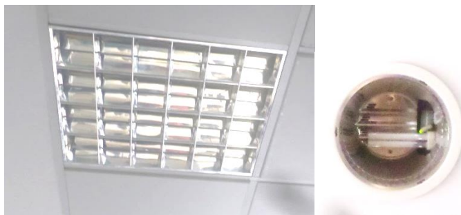
Figura 8.1 – Particolare delle lampade in sostituzione
