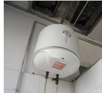
Figura 4.6- Particolare di un boiler elettrico per la produzione di acqua calda sanitaria
