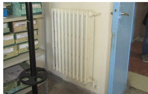
Figura 4.5 - Particolare radiatore installato a parete
