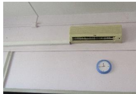
Figura 4.7- Particolare di split con macchina all’interno
