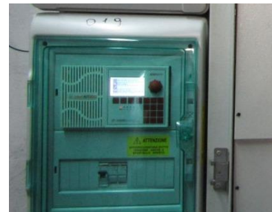
Figura 4.4 - Particolare del sistema di telecontrollo
