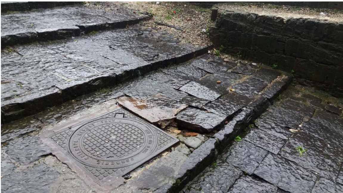
Figura 5 - Via Pedamentina: degrado e sconnessione degli elementi lapidei; ingresso di acqua nel sottosuolo
