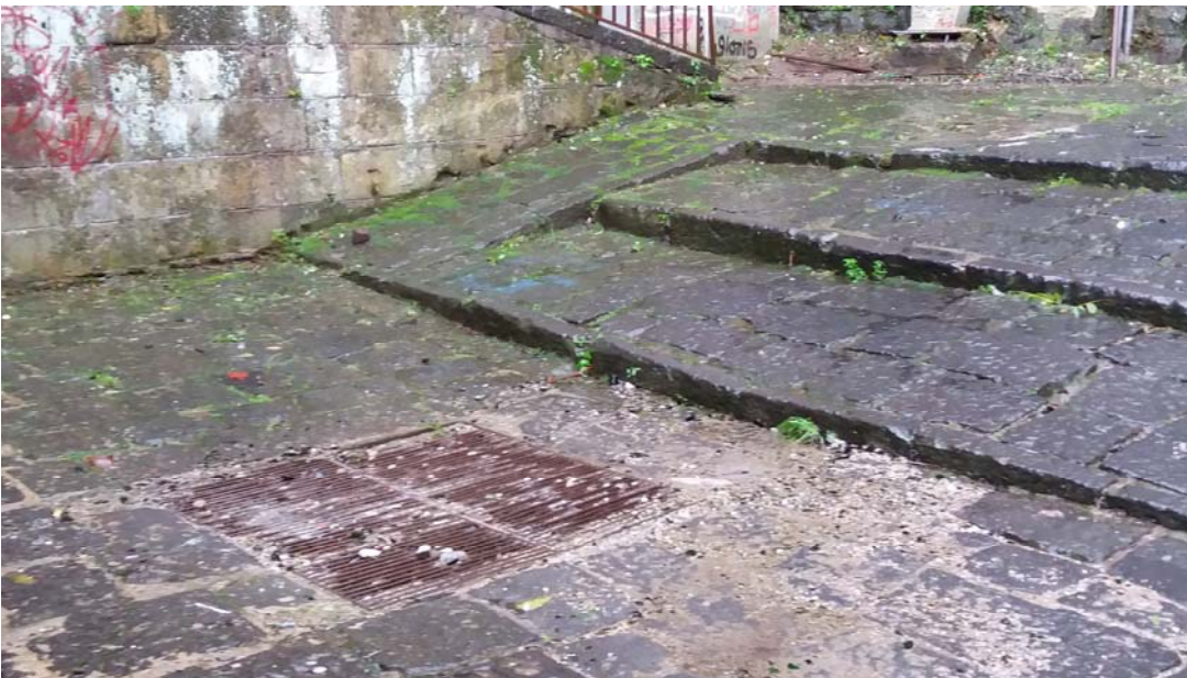
Figura 7 - Via Pedamentina accumulo di materiale a fine evento di pioggia
