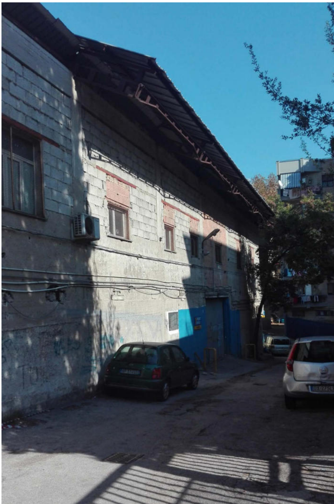
Foto n. 27. Strada privata via Nicolini n. 45 controcampo. Il vecchio capannone tagliato per l'apertura della strada. Si distinguono le unità al piano terra int. D ed al primo piano int. C
