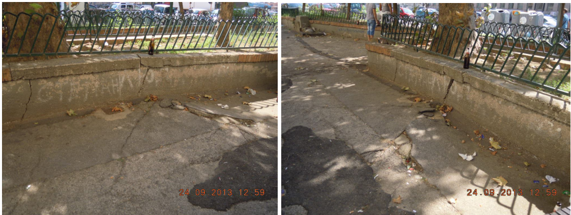
Fotografie 9-12. Lesioni da radici sulla pavimentazione e sui muretti di contenimento
