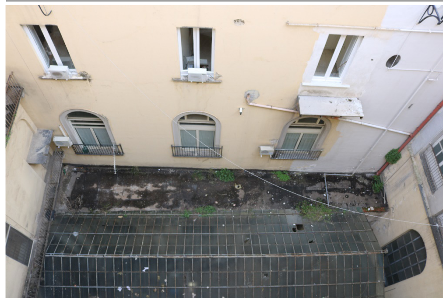
Figura 20– Degrado della corte che ospita la struttura in ferro e vetro del Gasse
