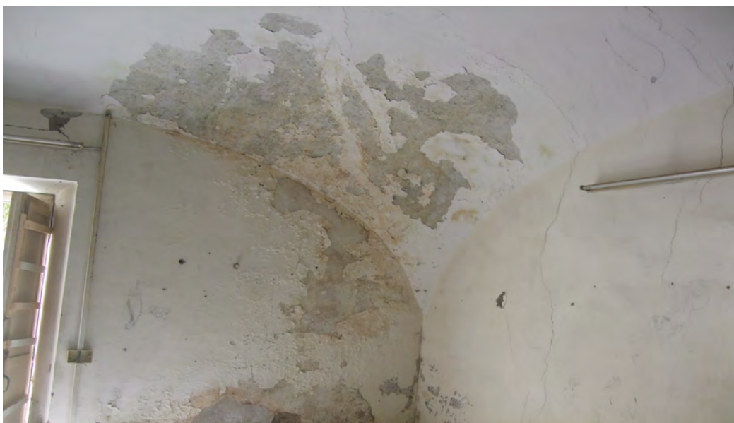
Particolare del degrado da infiltrazioni al piano terra della palazzina
