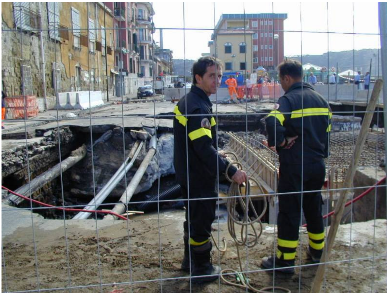
Intervento in Via di Pozzuoli per voragine dopo il nubifragio del 27.09.2007 in città.
