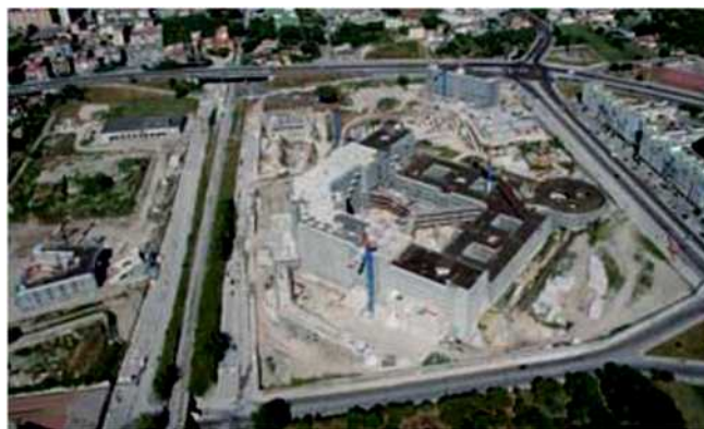
Fermo il cantiere dell'Ospedale del Mare a Ponticelli, avviata bonifica dai rifiuti
