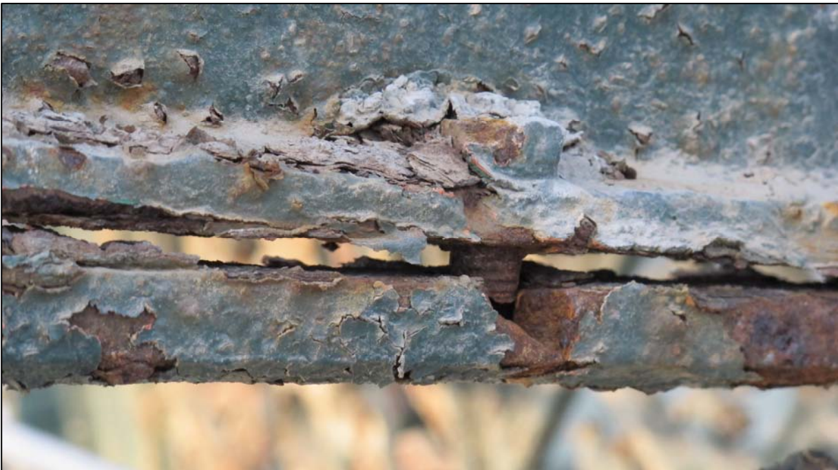
Particolare del bullone di collegamento tra mensolone e trave sopra mensola di sostegno della pensilina
