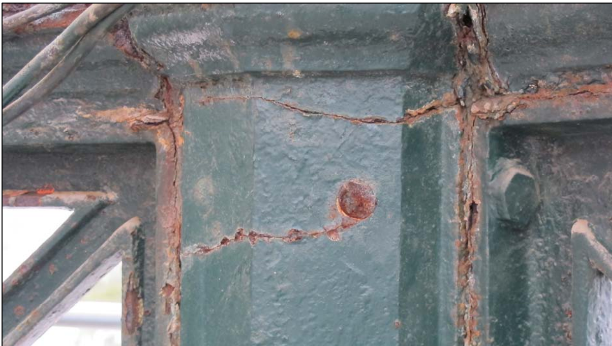
Fessurazione di una colonna in ghisa
