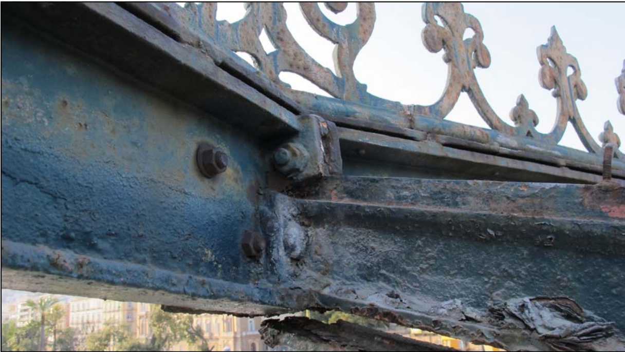
Dettaglio del collegamento tra i mensoloni e le travi perimetrali esterne della pensilina
