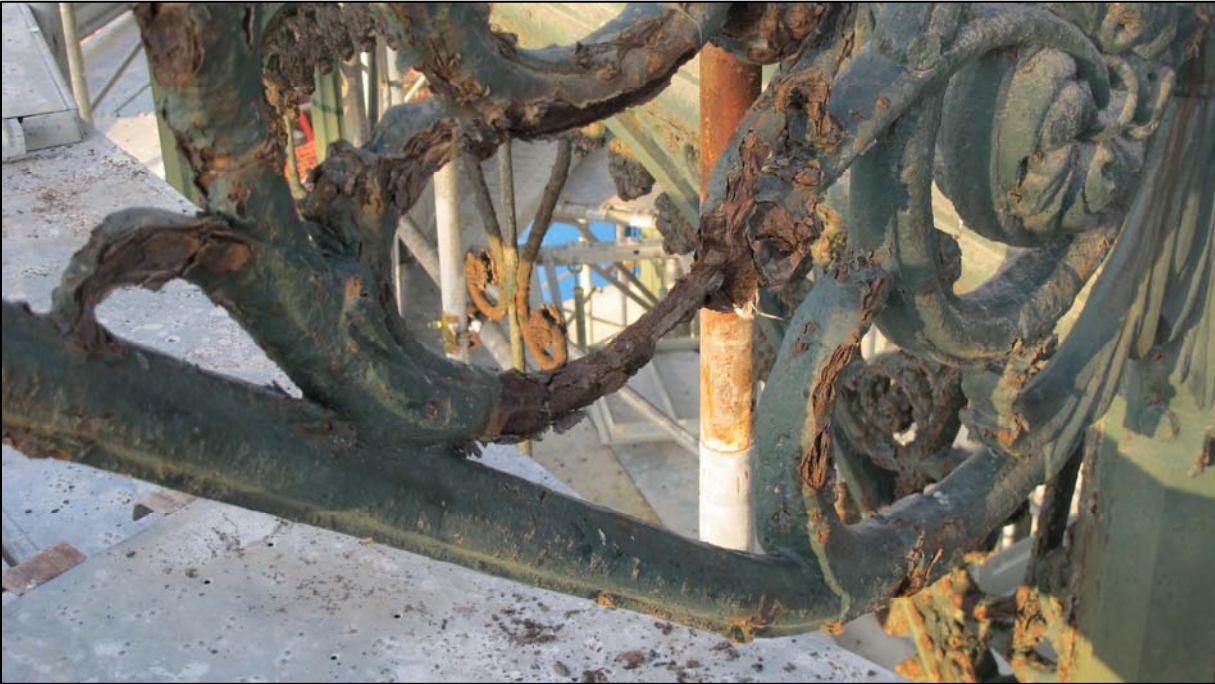
Particolare dell'avanzato stato di degrado del decoro dei mensoloni
