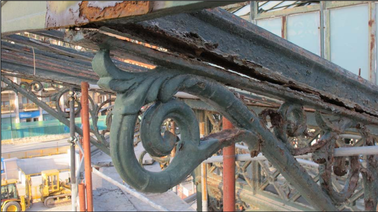
Distacco tra mensolone e trave sopra mensola di sostegno della pensilina prima dello smontaggio
